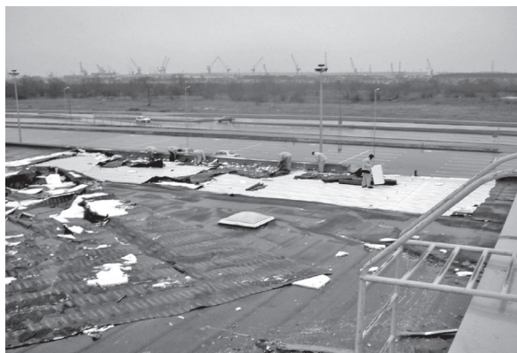
38 pav. Vėtros nuplėštas nepatikimai sutvirtintas prekybos centro plokščias stogas.
