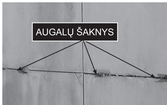
30 pav. Neteisingai įrengtos vėdinamos termoizoliacinės sistemos (su atviromis siūlėmis) fragmentas.
